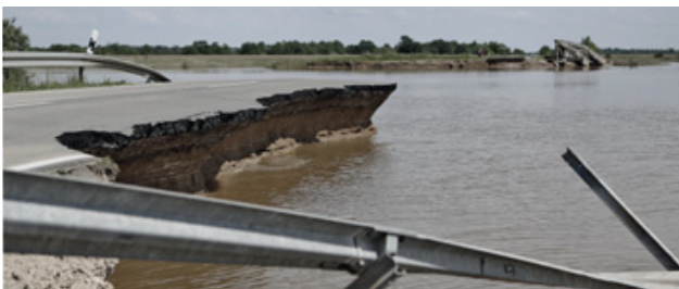
Seite 14 Bei Löbnitz bricht der Damm der Mulde
