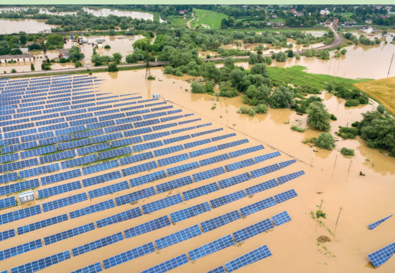
Überschwemmung einer PV-Anlage
