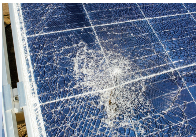
Schadenszenario: Freiflächen-PV-Anlage nach Hagelschlag
