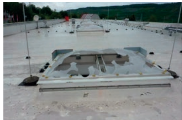
Hagelschaden: zerstörte Lichtkuppeln (Quelle: R+V Allgemeine Versicherung AG)
